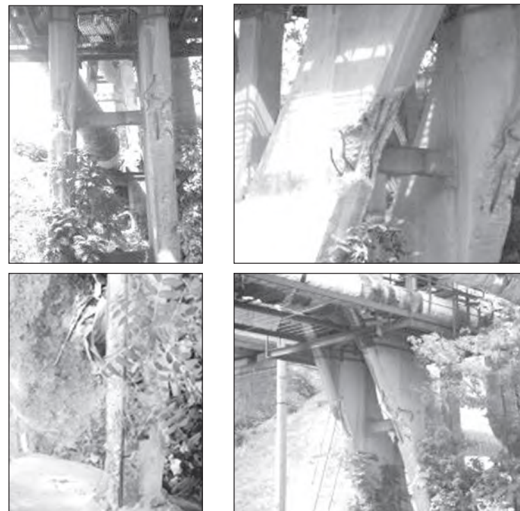
Рис. 1. Повреждения железобетонных опор транспортных сооружений
