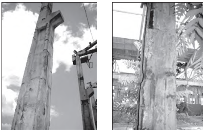
Рис. 2. Поврежденные колонны двутаврового профиля
